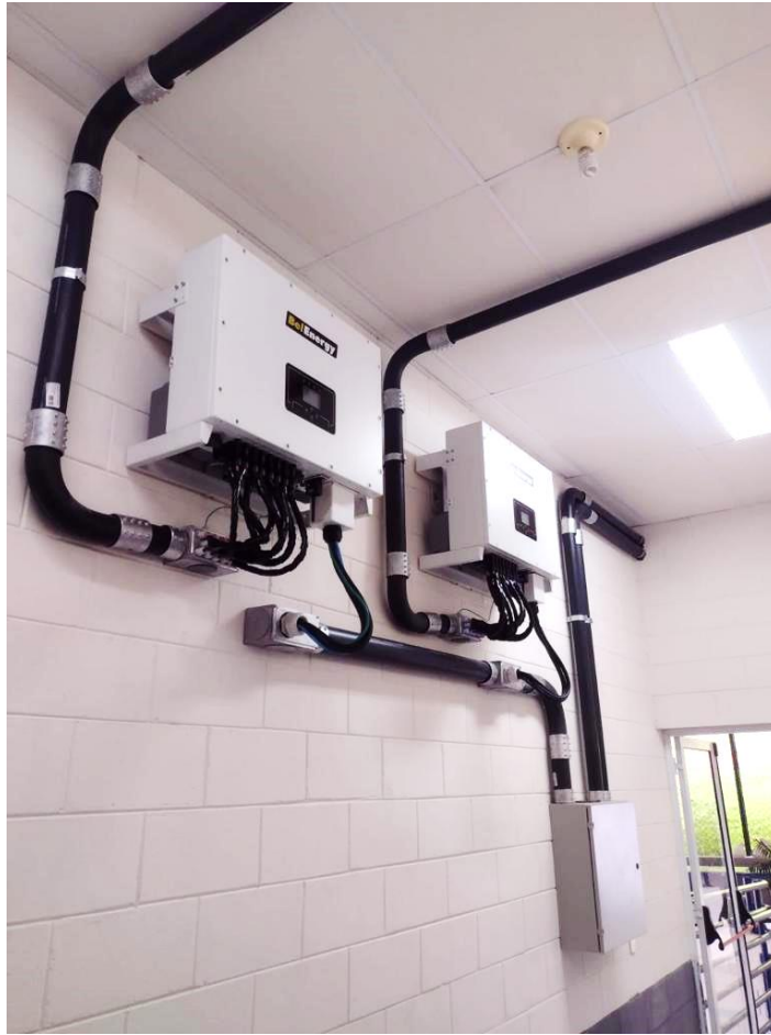
Figura 39 - Inversores da instalação do prédio JK.
