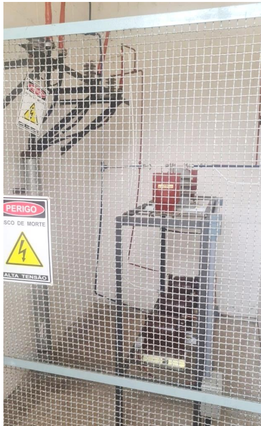
Figura 36 - Cabine Primária Centro Universitário Unifaat.
