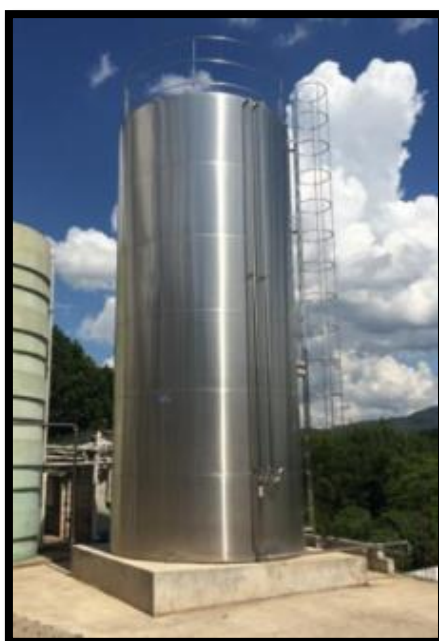
Figura 6 - Tanque de armazenagem
