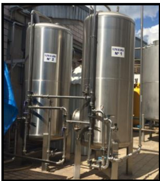
Figura 8 - Filtros de areia 1 e 2
