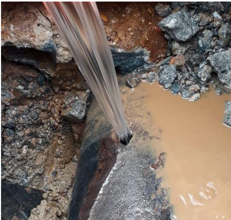
Figura 4 - Vazamento de rede de abastecimento
