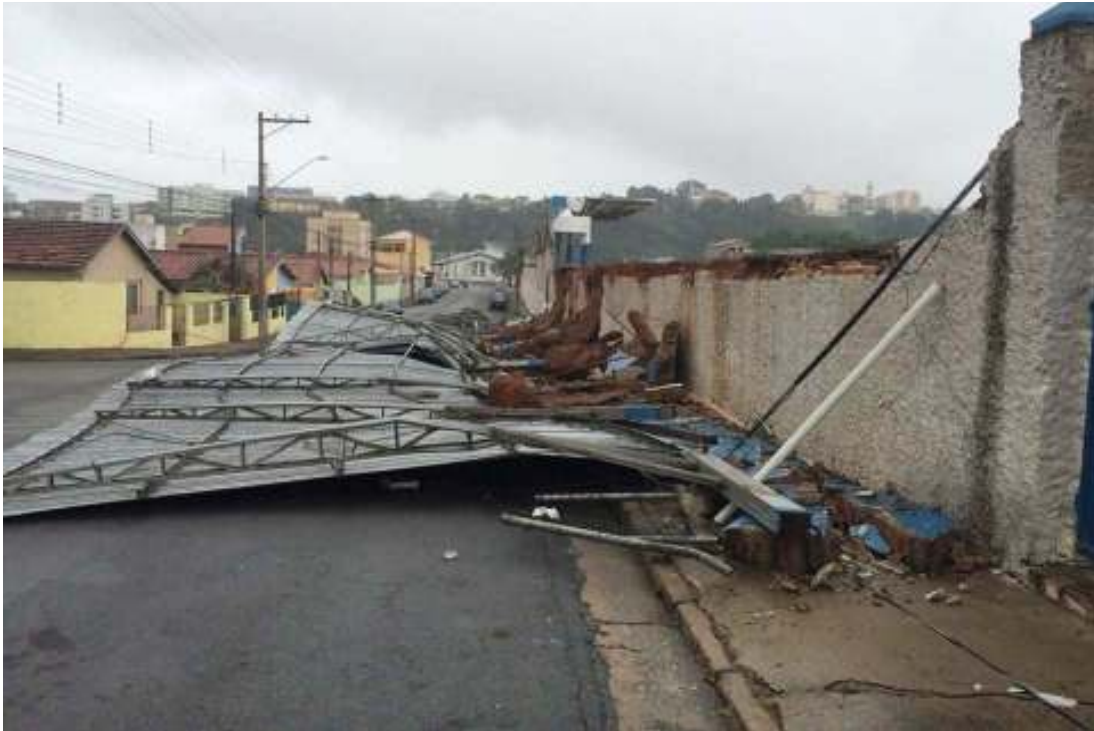
Figura 11: Queda de estrutura e telha após a chuva
