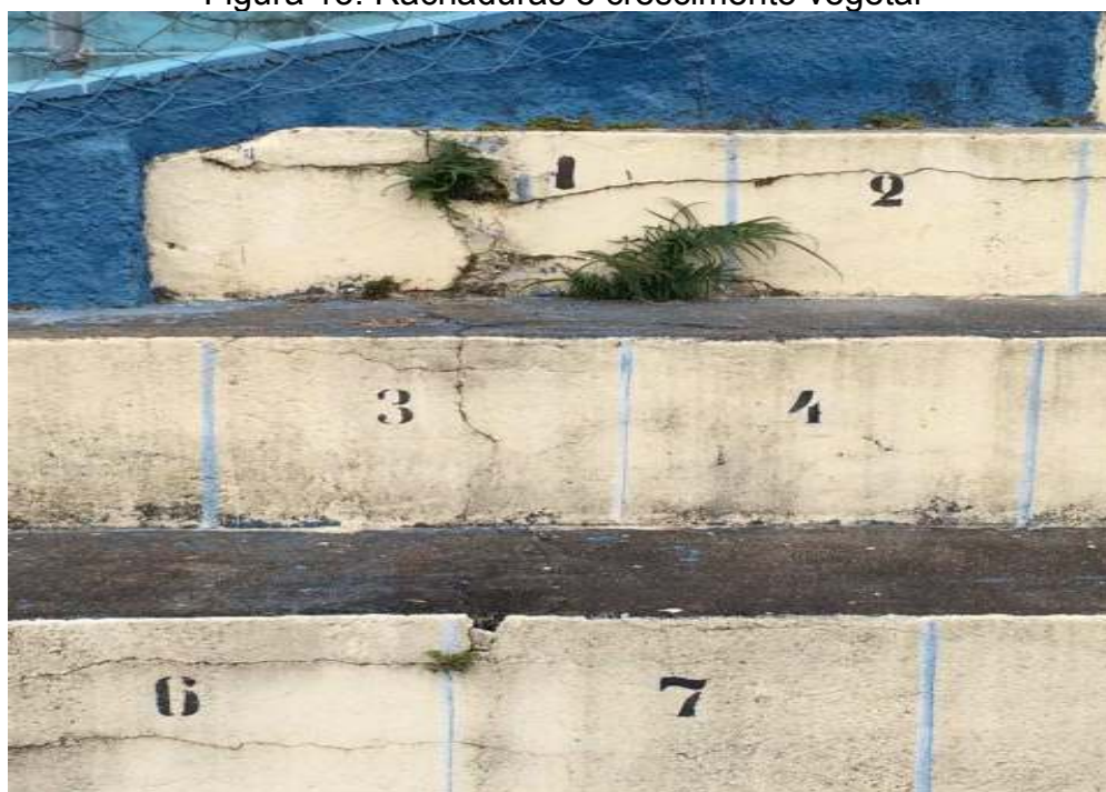
Figura 13: Rachaduras e crescimento vegetal
