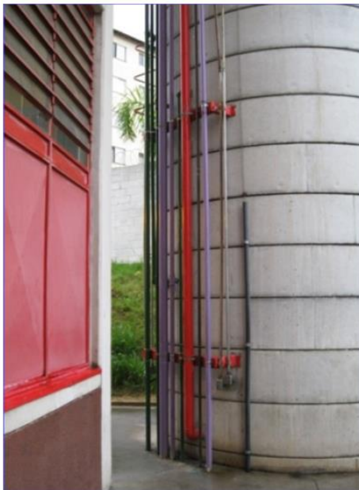
Figura 23: Tubulação de distribuição
