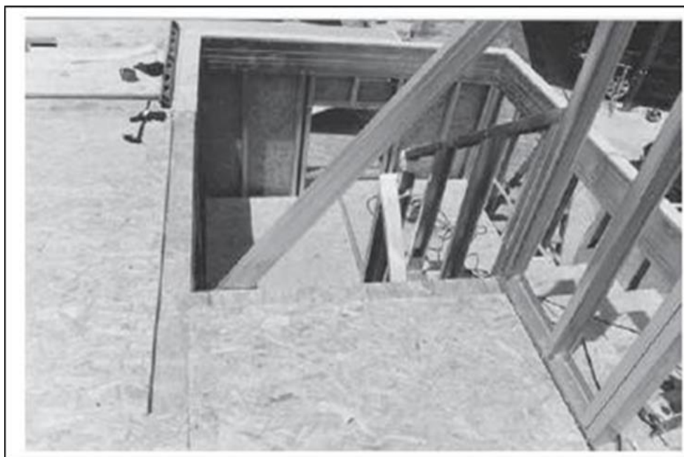
Figura 16: Placas de OSB utilizadas para laje seca.
