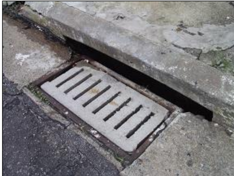
Figura 17: Boca de lobo com grelha
