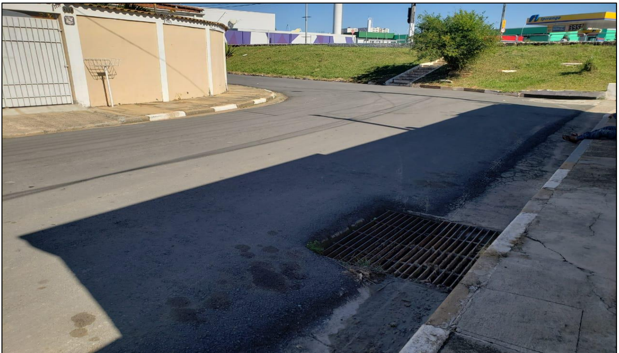
Figura 62: Grelha invadindo o leito carroçável
