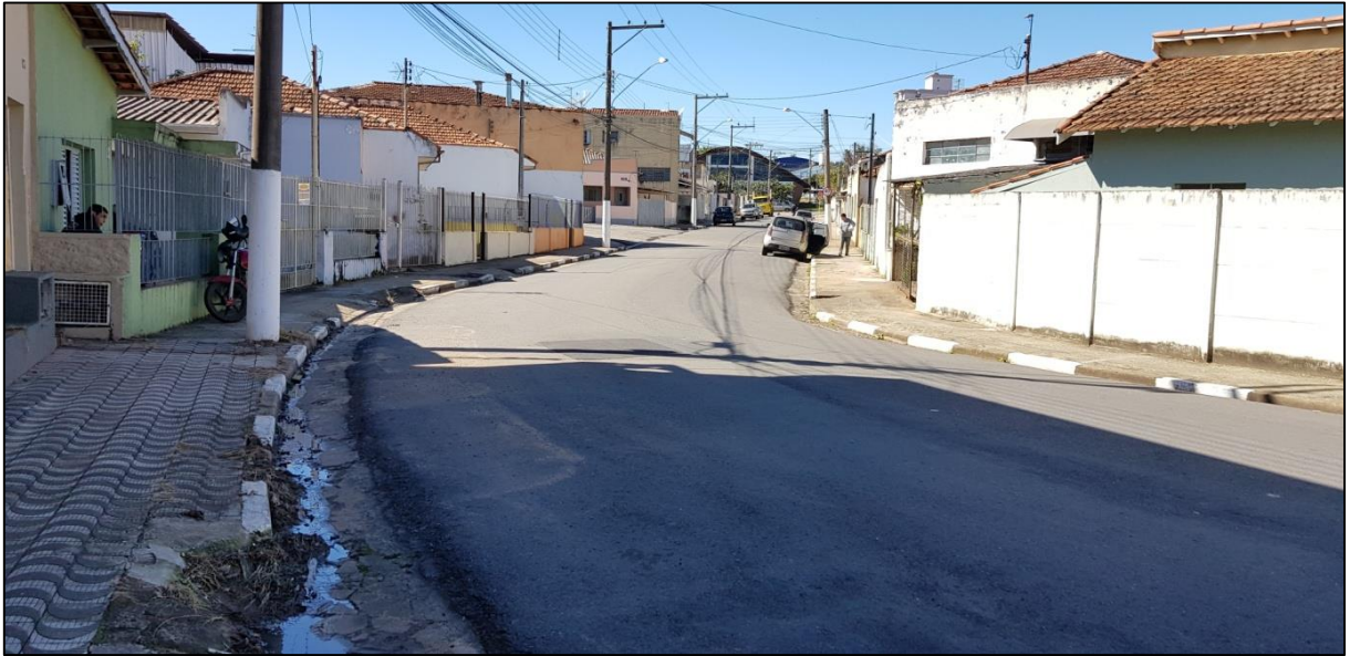
Figura 57: Acúmulo de sujeira e água nas sarjetas
