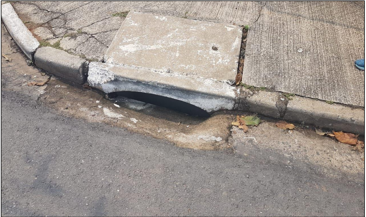
Figura 86: Boca de lobo localizada na área.
