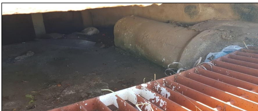
Figura 64: Tubulação no mesmo nível da boca de lobo
