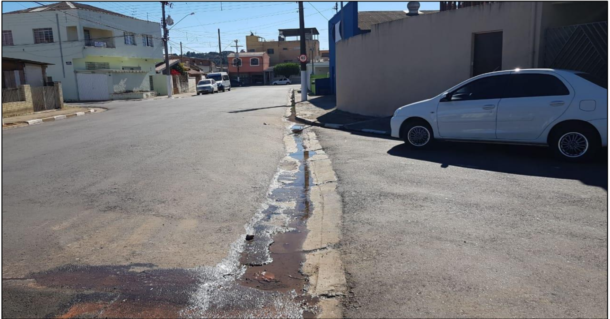
Figura 59: Sarjetão irregular e acumulo de água
