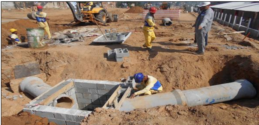
Figura 16: Poço de visita
