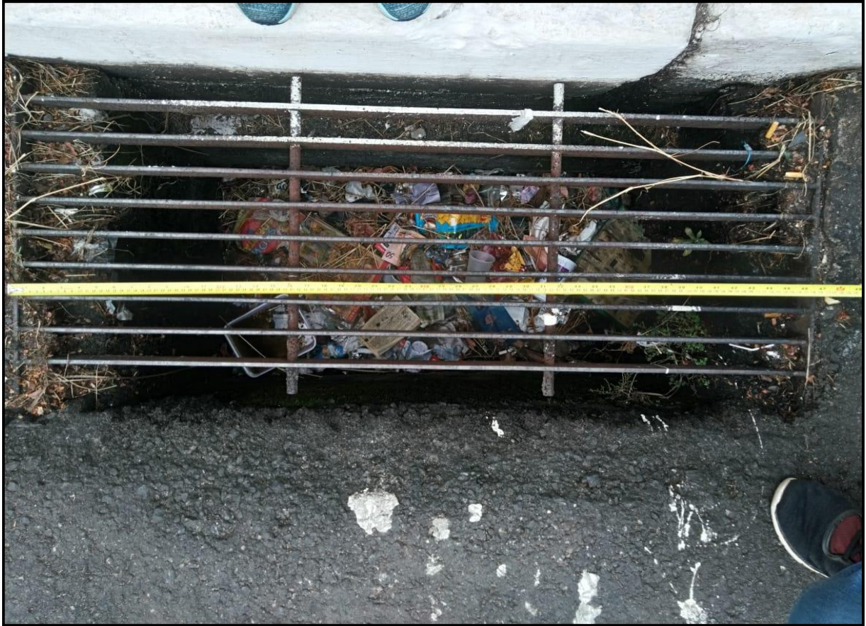
Figura 88: Boca de lobo tipo grelha, com lixo depositado pela população.
