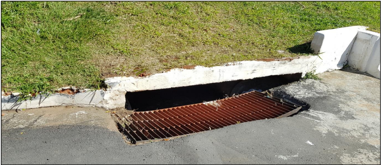
Figura 61: Boca de lobo combinada danificada
