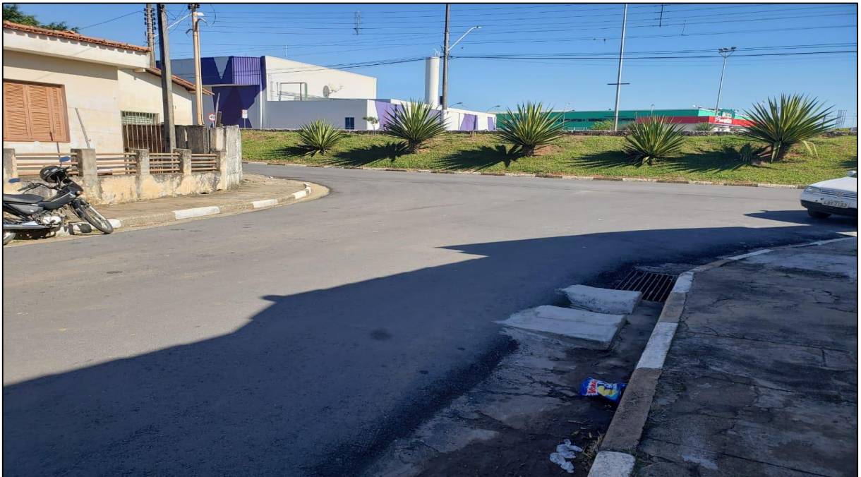
Figura 58: Guias e sarjetas irregulares, obstáculos e sujeira.
